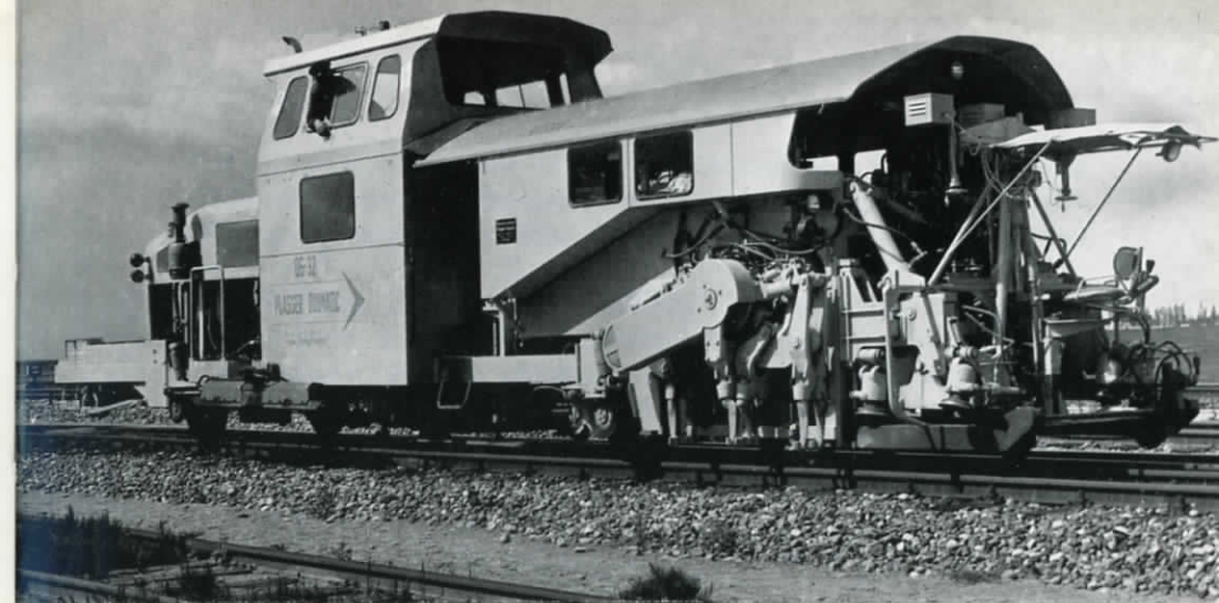
De stadig højere hastigheder kræver spor, der ligger godt. Håndkraft er de fleste steder erstattet af maskinkraft, når ballasten skal bankes fast under svellerne.
