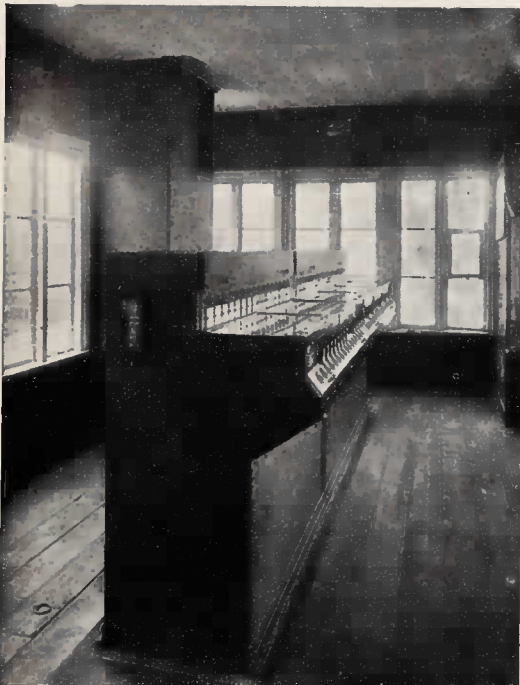
Fig. 178. Elektrisk Centralapparat af nyere Type (Siemens & Halske).
